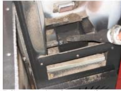
Pulire con aspirapolvere tutto il vano combustione ed il foro candeletta
